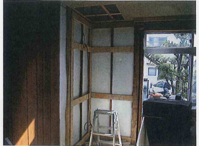
床～天井間に4本設置
